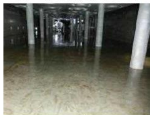
図5 第4貯蔵区域の床面(結露)
