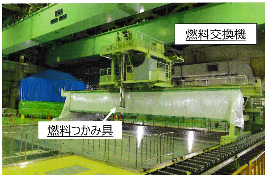
燃料交換機 全景写真
