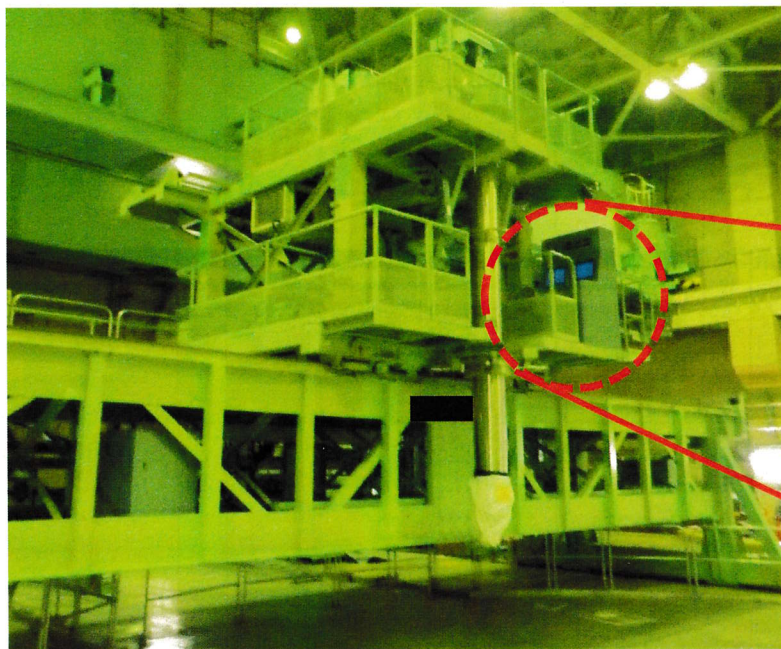
燃料交換機 全景写真
