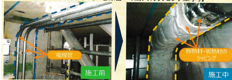
【追加で実施している「電線管への耐火材ラッピング工事」】
