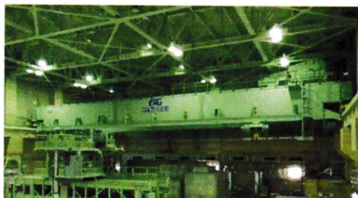
天井クレーン全景（写真）
