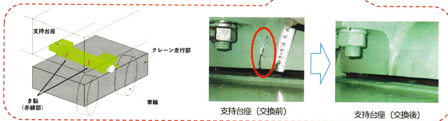
1号機 原子炉建屋天井クレーン走行部支持台座のき裂に係る概要図
