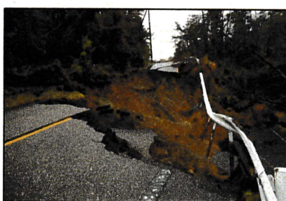
石川県七尾市の 道路被災状況
